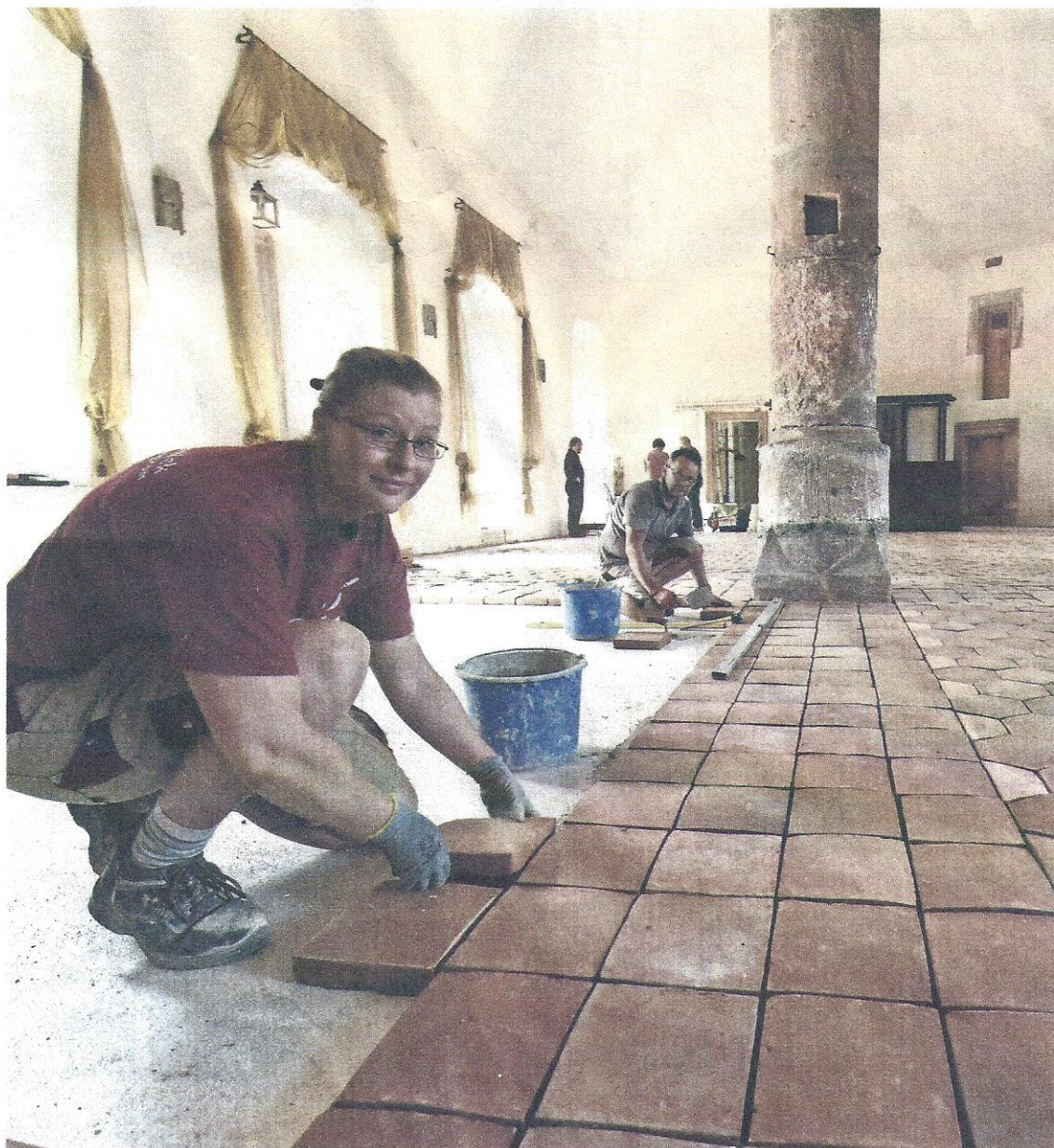
Fachmännisch: Melanie Arndt (li.) und Maik Reiche von der Trebsener Restaurierungsfirma Bernd Bubnick verlegen die neuen Fußbodenfliesen im Festsaal, die nach historischem Vorbild hergestellt wurden.
